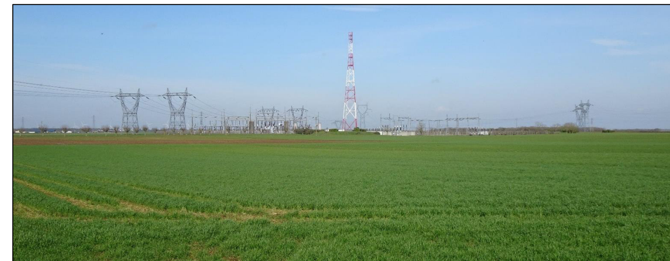
Figure 149 : Photographie du poste source à Assais-les-Jumeaux (Crédit photo : NCA Environnement)
